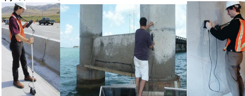
Приложение 1. Примеры применения импакт-эхо метода для определения толщины строительных конструкций: мостовой опоры, фундамента, стены
