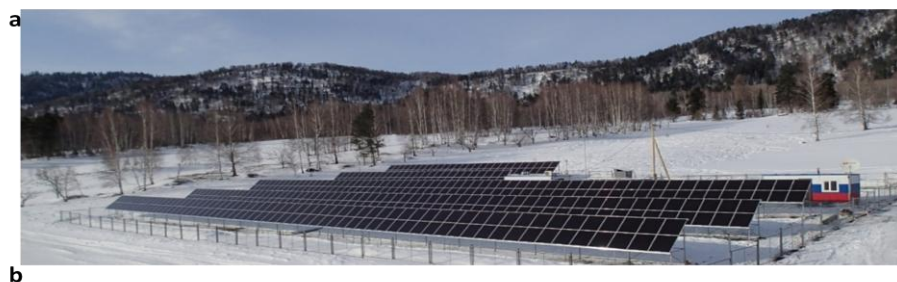
Рис. 2.27. Фотоэлектрические станции на a – Si:H на 5 МВт (а) и 100 кВт (в) Сибири.
