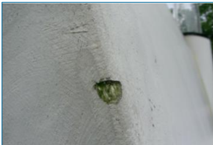
Рисунок 62. Повреждённая отделка со стеклянными волокнами (фото: Piero Medici, 2011) [78].
