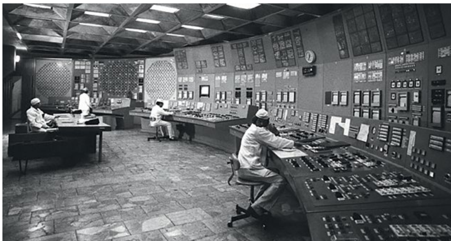
Блочный щит управления 4го энергоблока ЧАЭС
