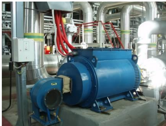
Вентильно-индукторный двигатель электропривода сетевого насоса РТС «Пенягино»
