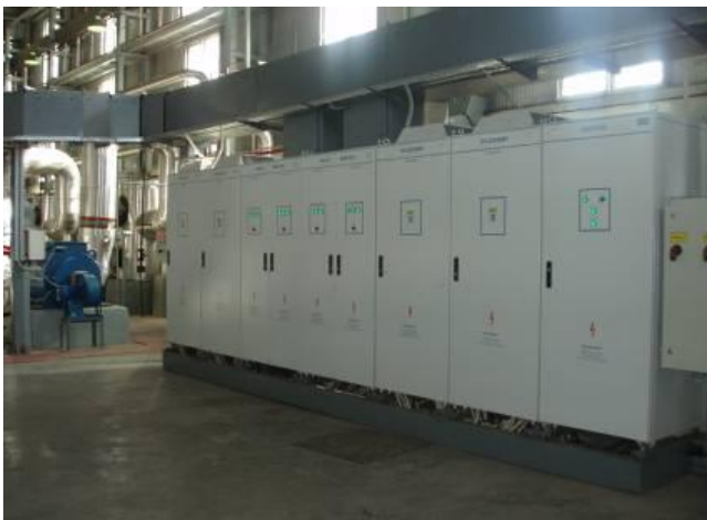
Электропривод сетевого насоса РТС «Пенягино»
