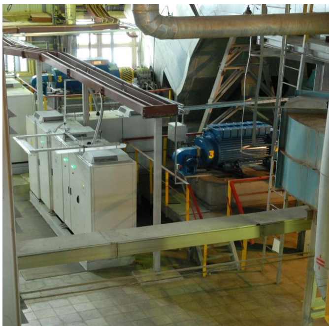
ВИП тягодутьевых механизмов котла КВГМ – 400 и 315 кВт РТС «Жулебино»
