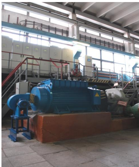
Электропривод сетевого насоса РТС «Коломенское»
