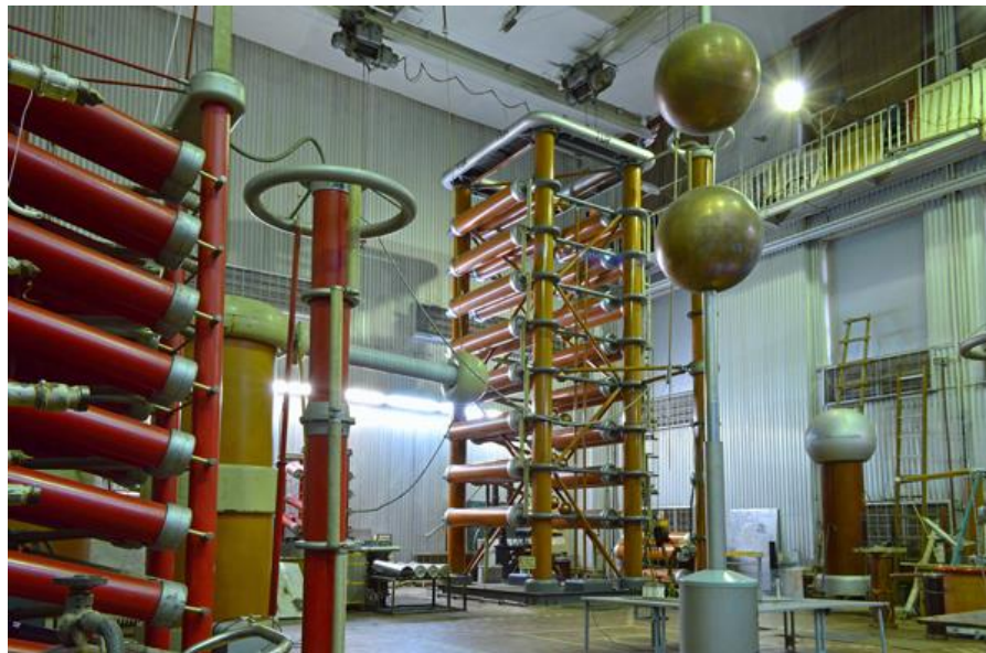
Высоковольтный испытательный зал НИУ МЭИ
