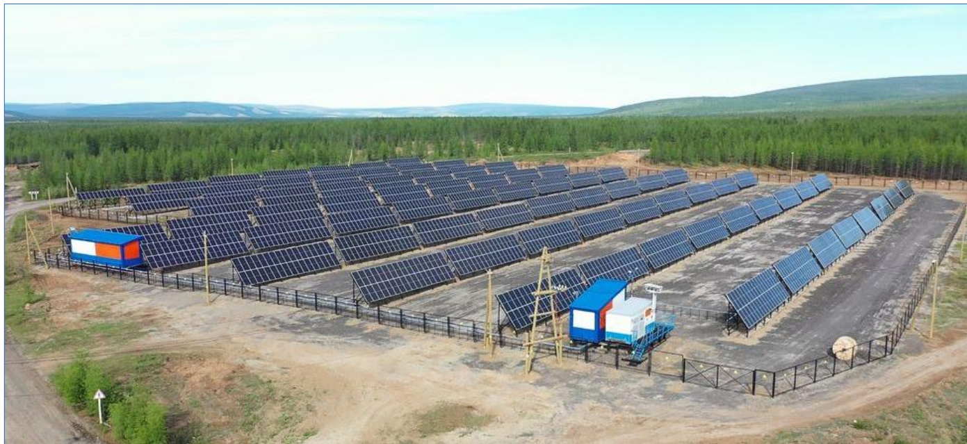
Солнечная электростанция (СЭС)
