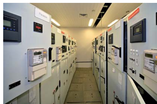
Новое оборудование ТЭЦ МЭИ
