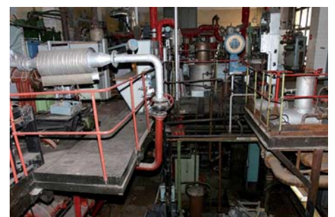
Оборудование ТЭЦ МЭИ до реконструкции
